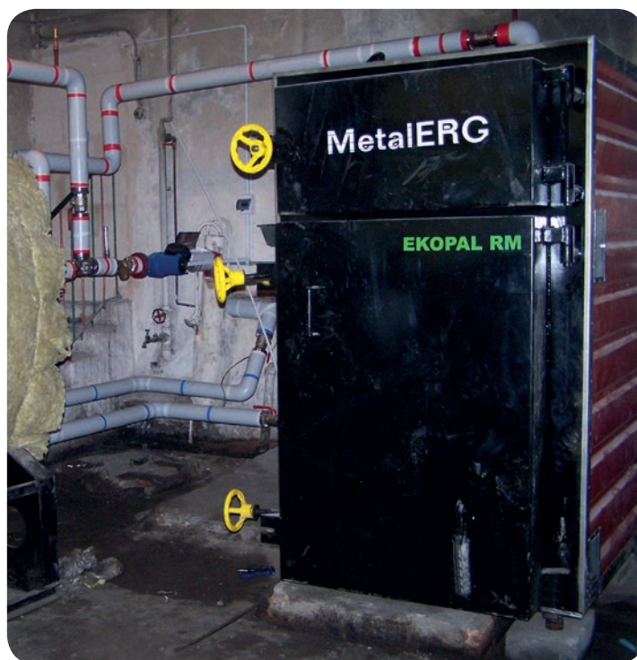
Kocioł na biomasę w Szkole Podstawowej we wsi Wysoka. Fot. M. Kowalski
