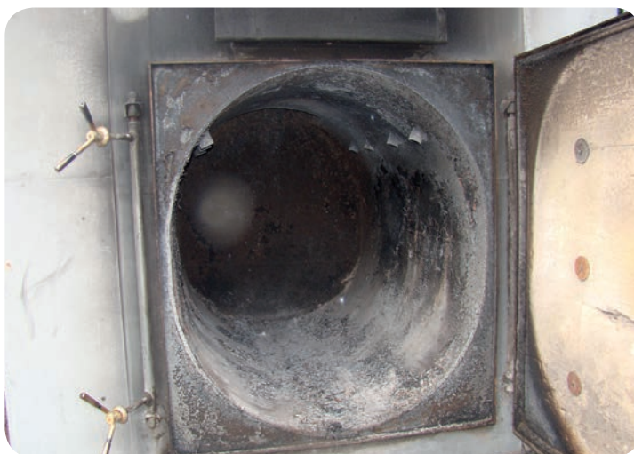
Bardzo dobry stan kotła po rocznej eksploatacji – obiekt Myślibórz 11. Fot. T. Horoszko
