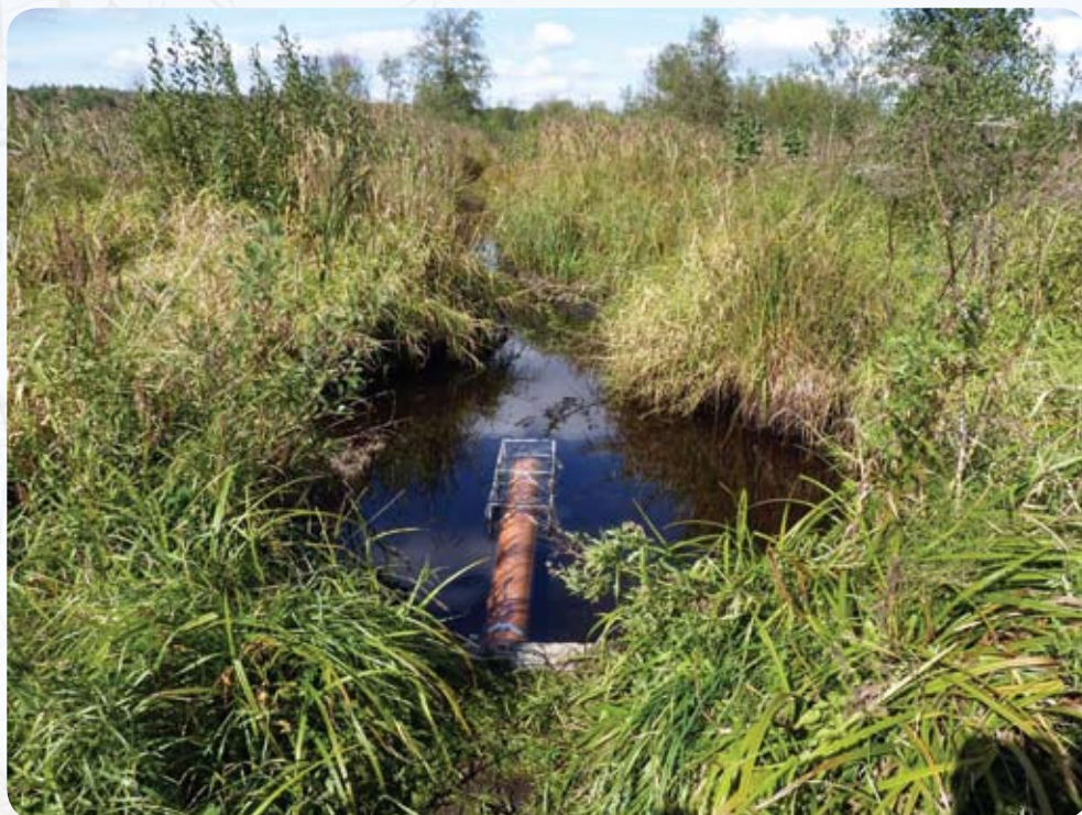
Fot. Urządzenie regulujące poziom wody w cieku wodnym (IW)
